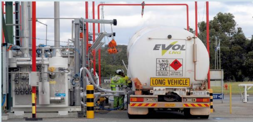
Truck loading at Kwinana LNG plant
